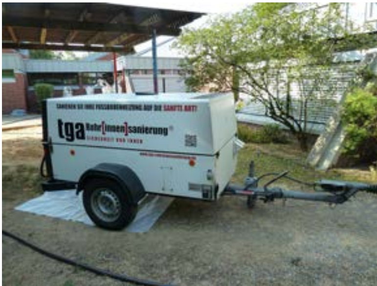
▲ Bild 3 • Objekteinrichtung im Außenbereich: der Kompressor.
