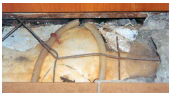
▲ Durch Versprödung gebrochener Fußbodenheizkreis
