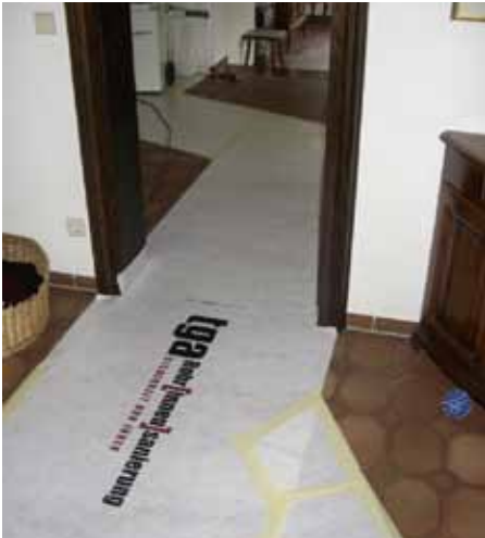
Das Team von TGA Rohrinnensanierung klebt vor der Arbeit die Laufbereiche mit einem Schutzvlies ab.
