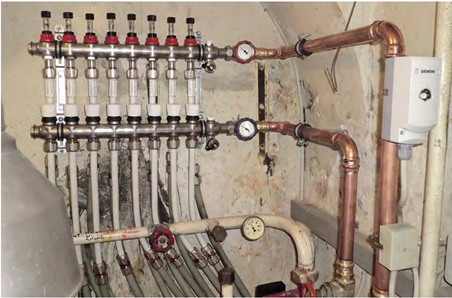
Notwendig war ein neuer Verteiler mit Durchflussanzeige.
