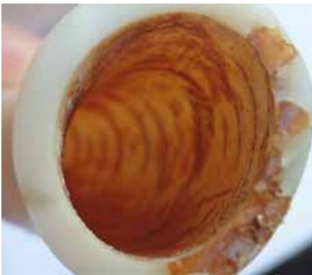
Versprödung an diffusionsoffenen Kunststoffrohren mit Rissbildung von innen.
