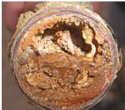
Verschlämungen im Verteiler der Fußbodenheizung im Detail.
